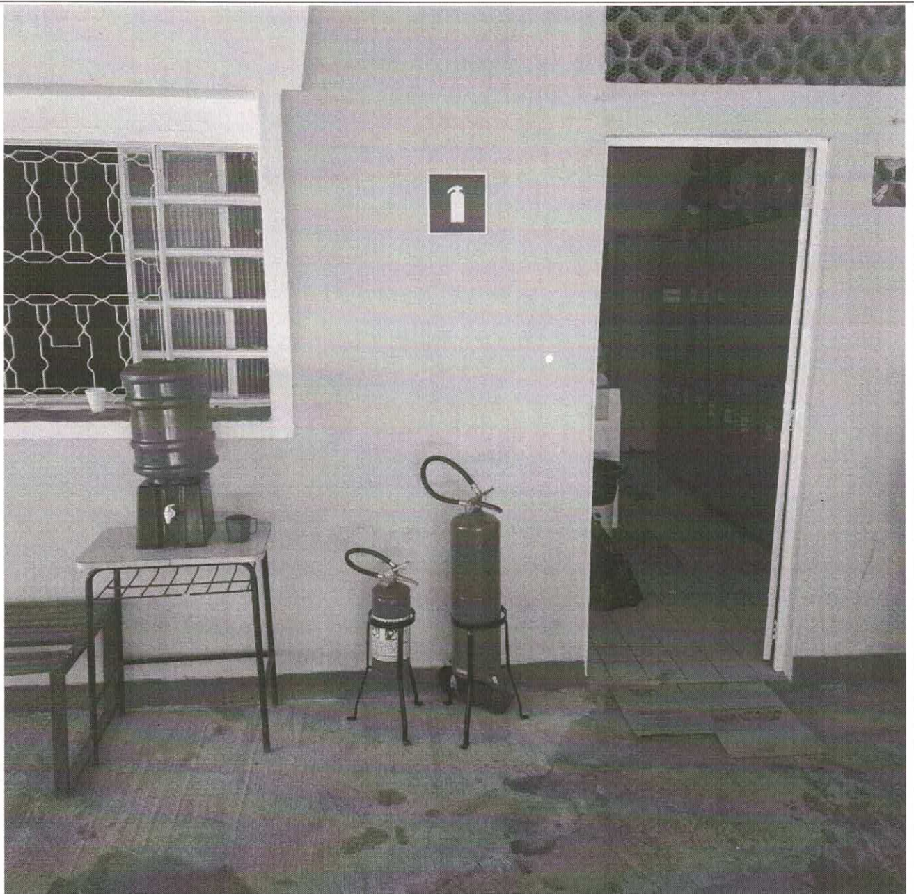
8 - Extintor e placa próximos à área de serviço/lavanderia
