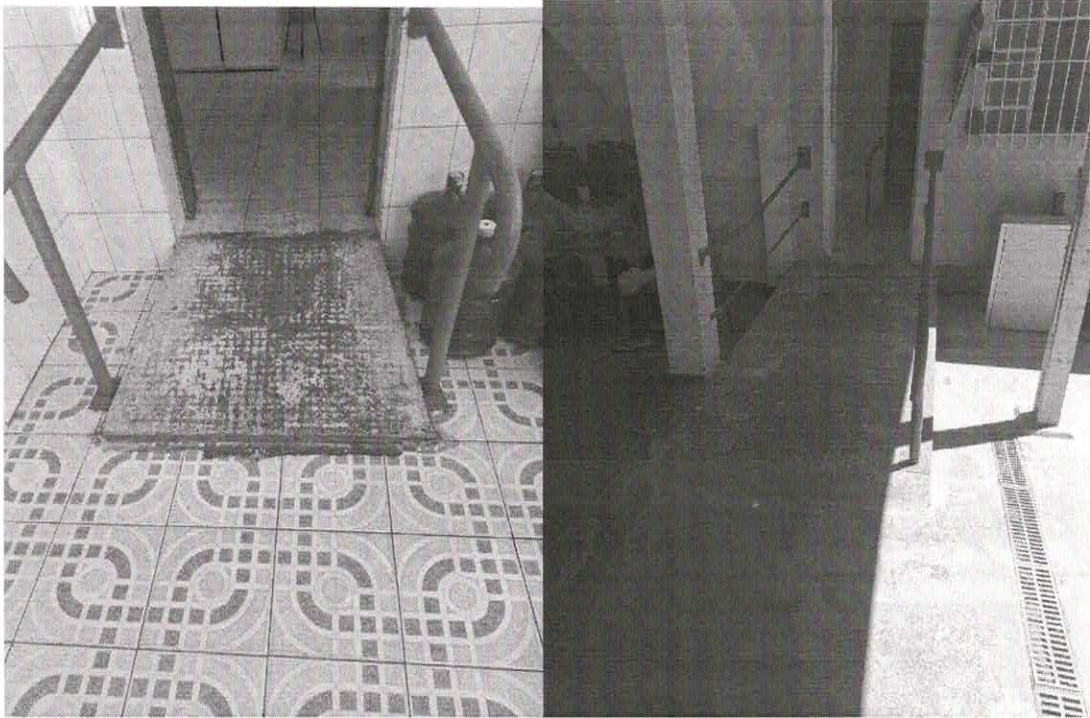
12- Rampas interna e externa (ausência de piso antiderrapante)
