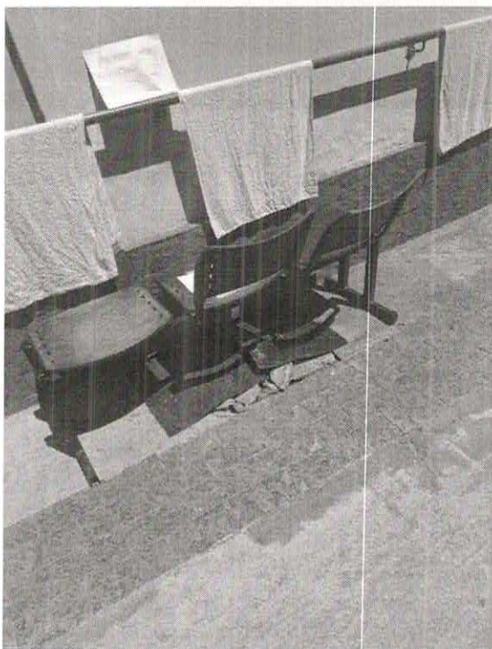
15- Local do vazamento
